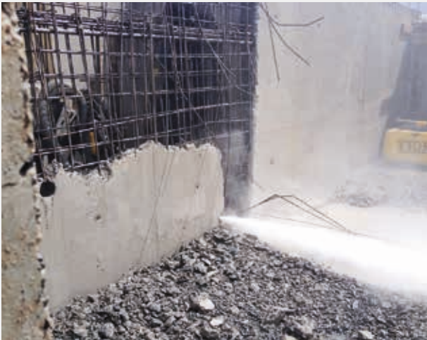
Wegnemen muur na levering verkeerde betonkwaliteit.
