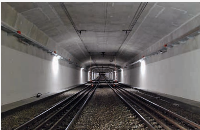
Brandbescherming van een tunnel door middel van brandwerende platen.
